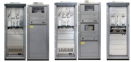
ローライザー装置 グライド・スロープ装置 T-DME装置
